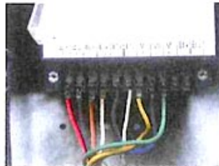
[地絡継電器 下部]
