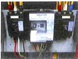
[地絡継電器 正面]
