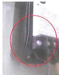
[継電器本体損傷]
