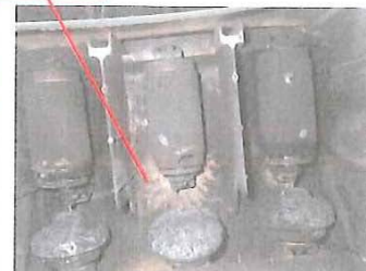
[真空遮断器内部]
