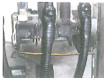
[真空遮断器裏側 拡大]
