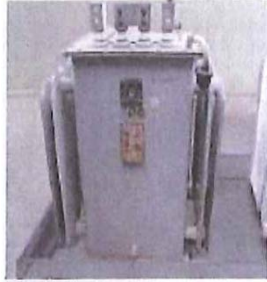
高圧トランス
