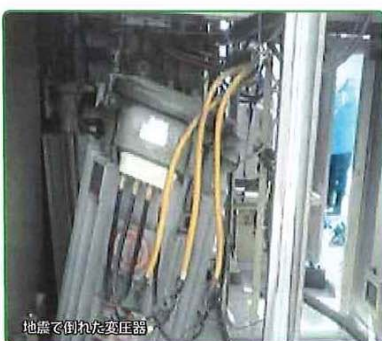
地震で倒れた変圧器
