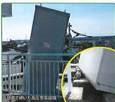
地震で傾いた高圧受電設備
